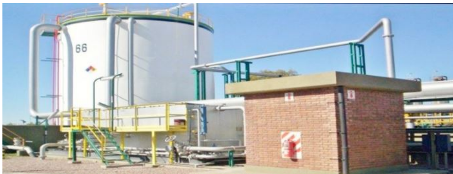
Figura 5.1.7: Tanques en la batería.
