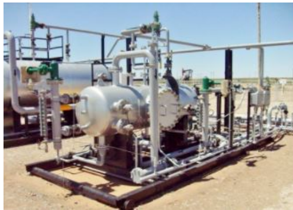
Figura 5.1.6: Separadores en la batería.
